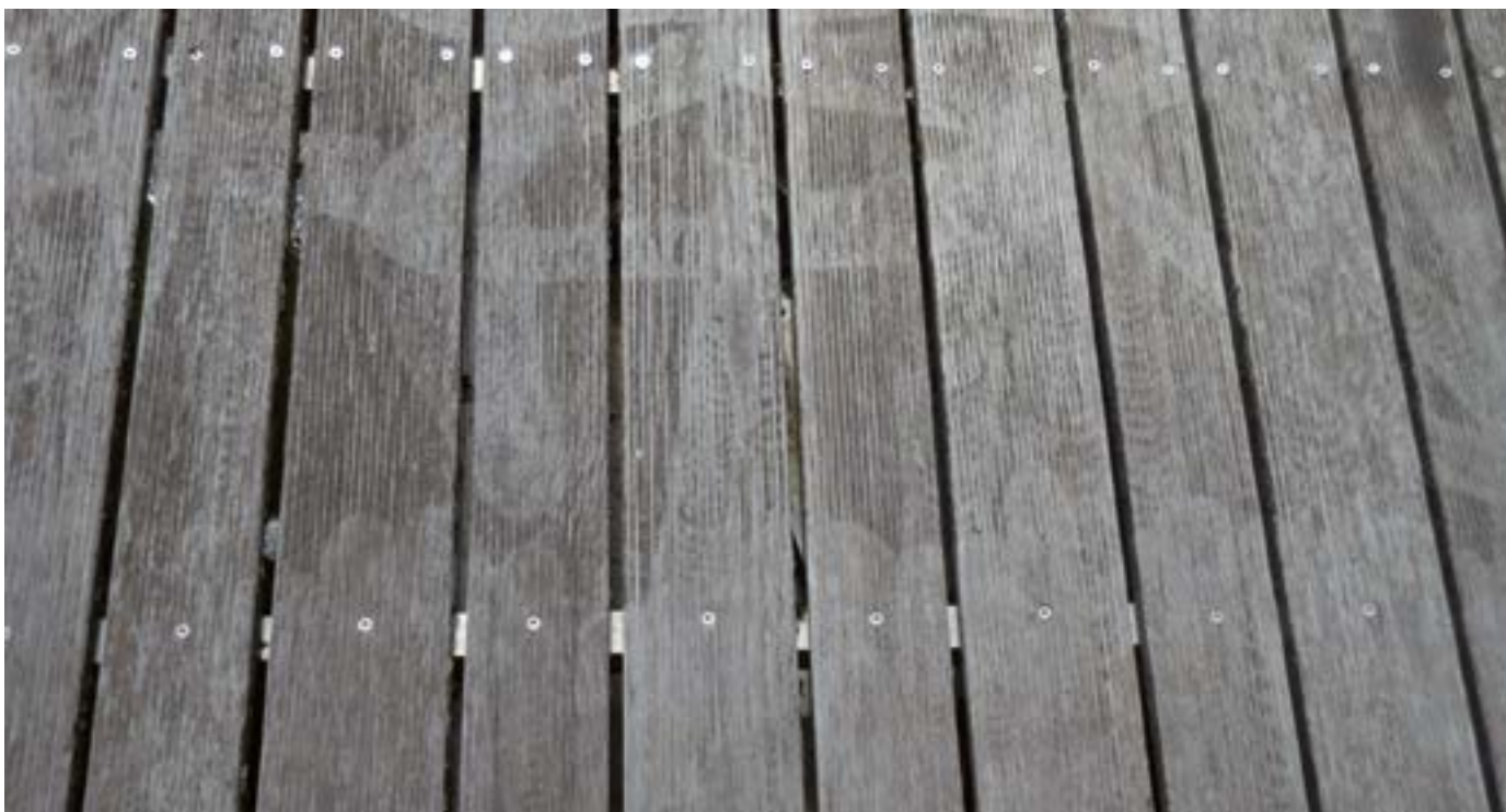
Die Fläche wurde mit einem Hochdruckreiniger gereinigt, wodurch sichtbare Farbunterschiede auf der Oberfläche entstanden sind.
