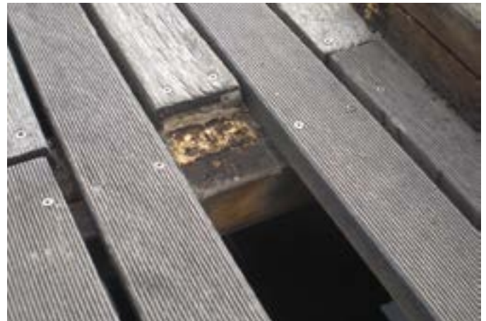
Die Ausführung auf nur 1 Unterkonstruktion führt zu einer Pilzbildung.
