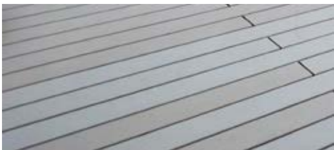
Farbunterschiede durch Nichtbeachtung der Verlegerichtung.
