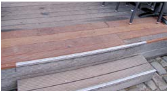
Bei stark genutzten Flächen kann ein Austausch erforderlich werden.
