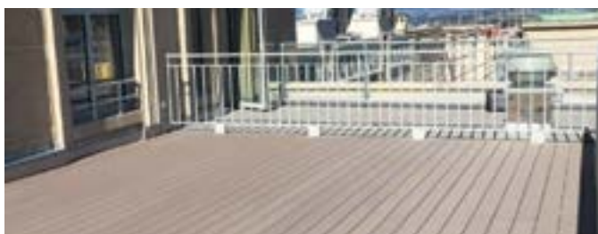
Besonders bei Dachterrassen kann es an Metallgeländern vereinzelt zu einer elektrostatischen Aufladung kommen.
