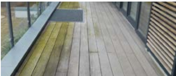
Ohne Reinigung entsteht ein Grünbelag wodurch die Terrasse rutschiger wird.
